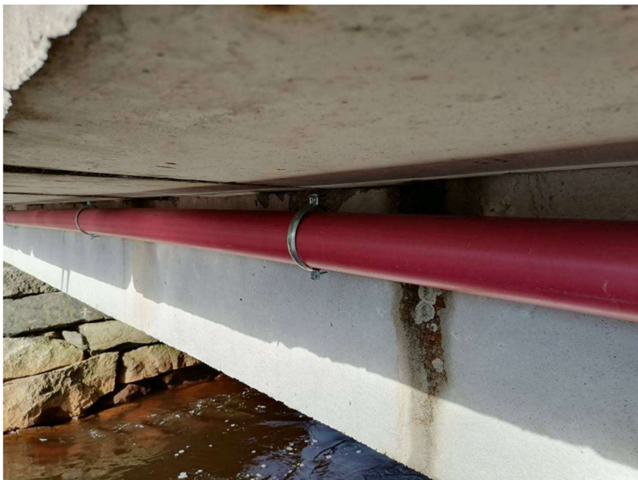
Kuva 2. Kaapeli vanhassa sillassa.
